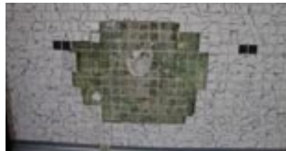
Old spandrel tiling
